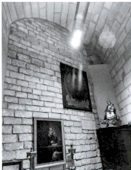
FIGURA 11: Detall de la paret del campanar des de dins de la resagristia, on s'observa la cornisa repicada
