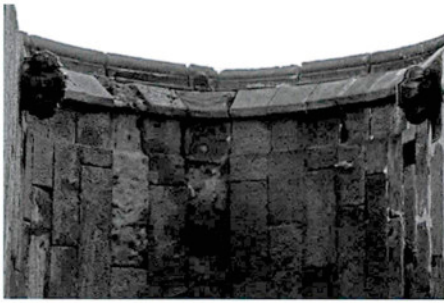
FIGURA 4: Detall d'un dels finestrals del cloquer del campanar, on s'observa l'encaix previst per a les traceries
